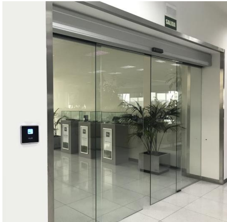
Figura 4. NÜO Awa lector de biometría y proximidad en puerta automática de acceso a la oficina.
