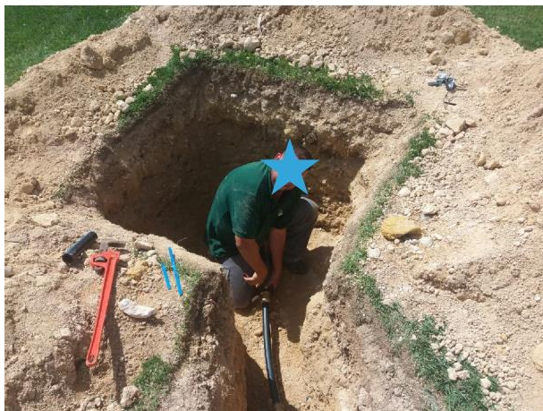
Figura 1. Reparación de fuga sin daños visibles, detectada en comunidad situada en Arenales del Sol – Elche, Alicante (Abril'18).
